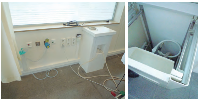
Foto 6.32. y 6.33. Puesto de diálisis: tomas y registro de instalaciones (oxígeno / vacío; electricidad; voz / datos; agua / desagüe).
