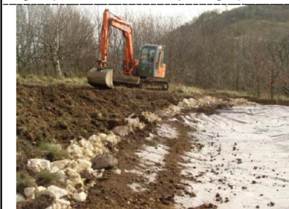
Fig.02: Construcción de charca artificial mediante lámina TPO termosoldable y geotextil en el Parque Lau Haizeta (Rentería, Guipúzcoa). (Fuente: ATALAYA)
